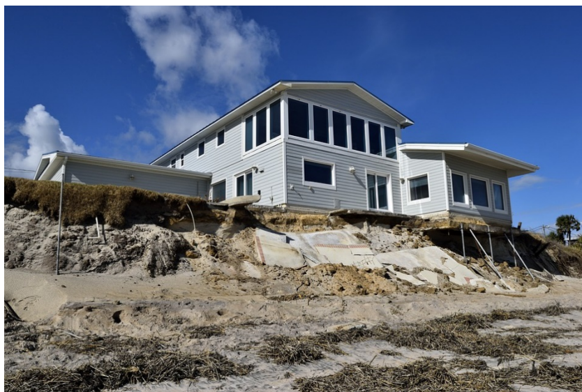
Erosão marinha (invasão do mar em casas, ao longo da praia)
