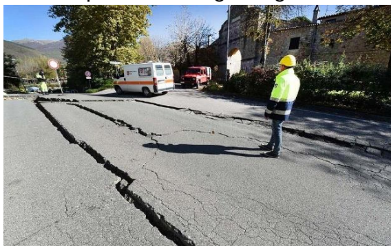
Fissuras no solo provocadas por terremoto.
